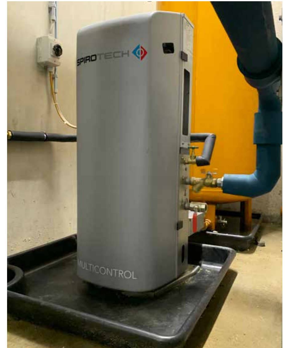
De expansievaten zijn geïnstalleerd aan de zuigzijde van de circulatiepompen, dat in dit project ook de centrale retourleidingen betreft.
