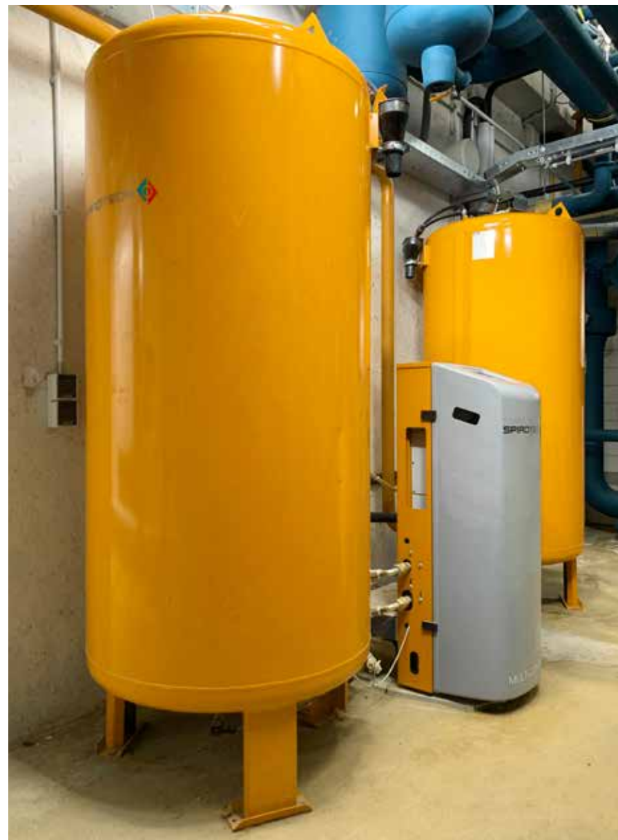
Om drukverschillen efficiënt op te vangen, zijn aan de verwarmings- en koelinstallaties in het ING hoofdkantoor twee SpiroPress Multicontrol Modular expansieautomaten gekoppeld.
